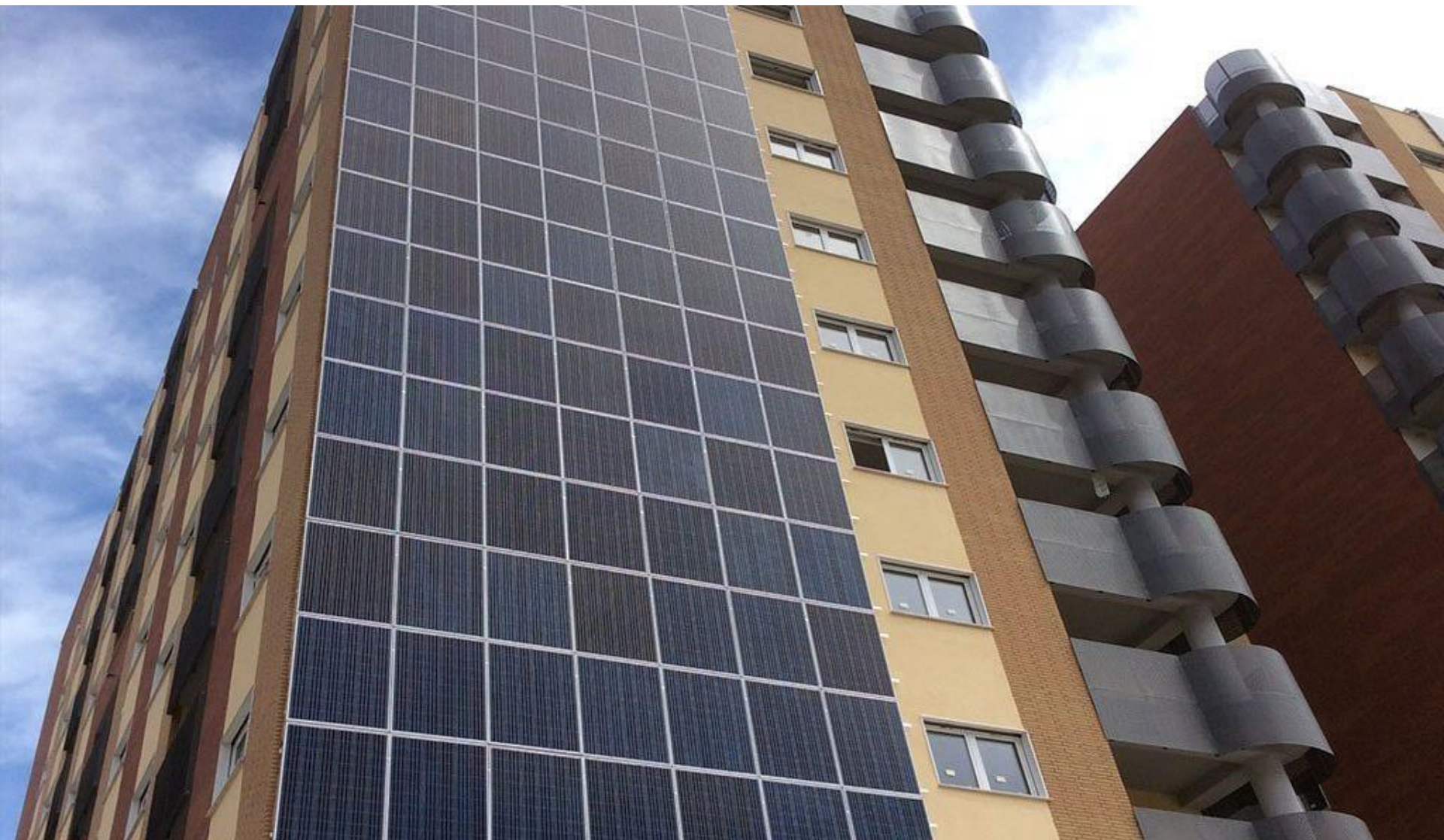
FAÇADE AVEC PANNEAUX PHOTOVOLTAÏQUES
