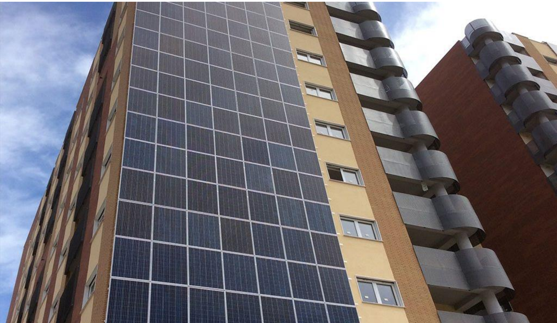
FACCIATA CON PANNELLI FOTOVOLTAICI
